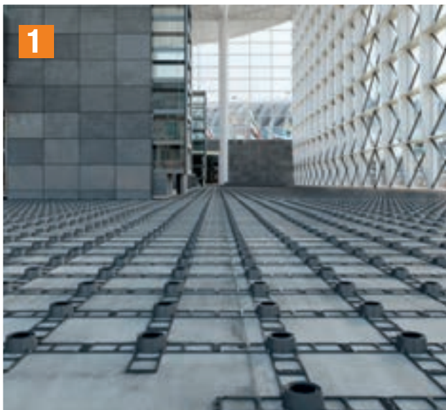
1 Pose de grilles dans la zone destinée à recevoir le plancher surélevé.
