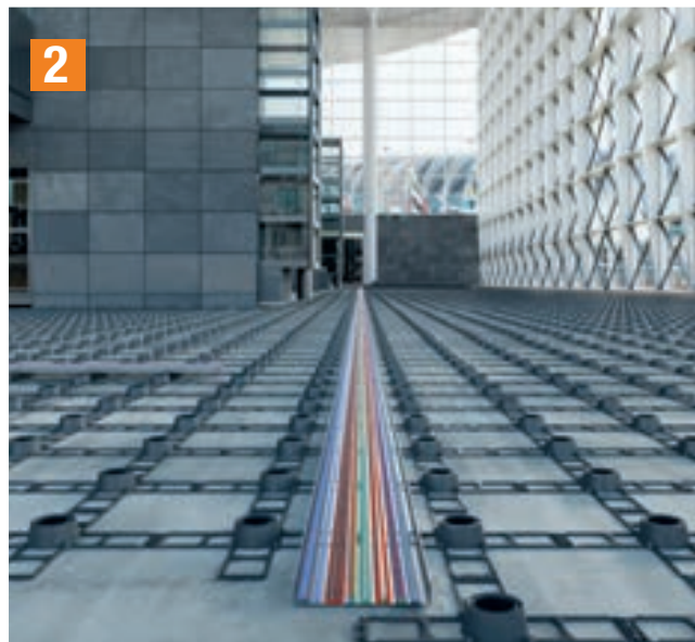
2 Le système de grille facilite la pose des installations en créant une matrice utile pour le routage simple.
